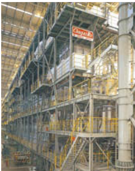
冷延鋼板連続焼鈍設備 (CAL)
