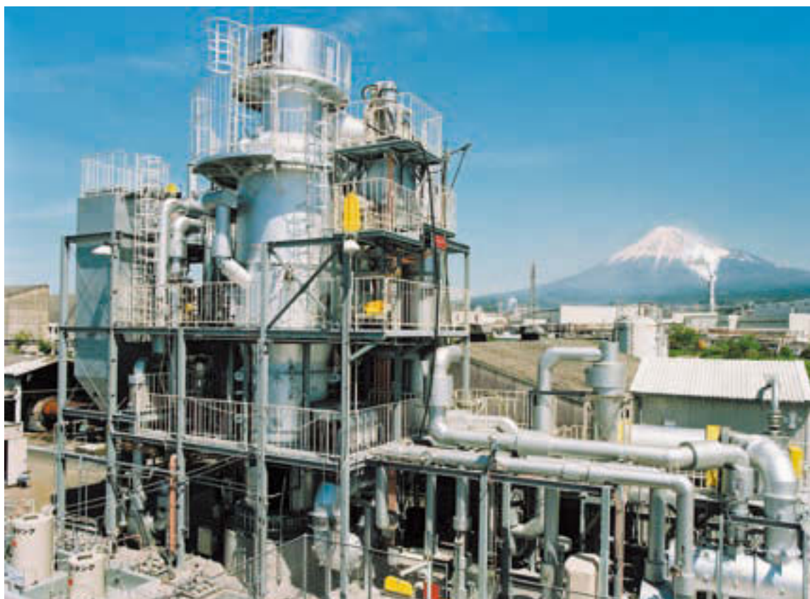
流動床式加熱設備
