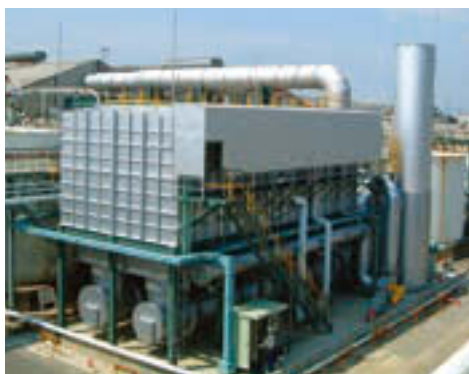
5塔式蓄熱排ガス処理装置 (RTO)
