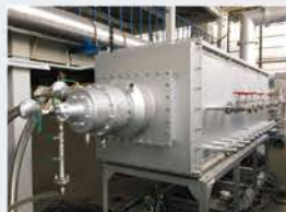
Ammonia Burner 氨燃烧器
