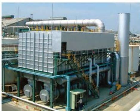
5 Chamber Type Regenerative Thermal Oxidizer (RTO) 5塔式蓄热废气处理装置 (RTO)
