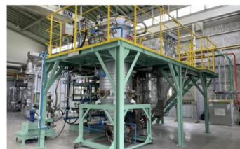
火炎内処理設備の受注も継続
